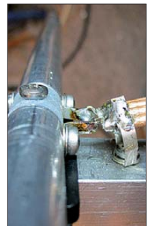
Bild 10: Erst knapp vor dem Dipolanschluss treten die vier RG179-Kabelenden aus dem Boom hervor. Alle Abschirmgeflechte sind direkt an ihrem Ende miteinander verbunden und auf „Antennenmasse“ gelegt.
